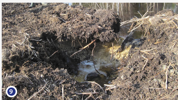
La surverse sur la digue génère très rapidement une brèche par érosion
