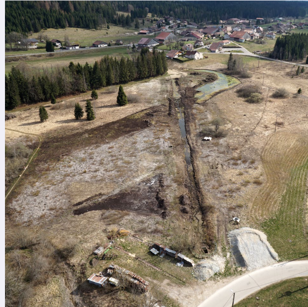
Travaux de neutralisation du fossé de drainage de la tourbière du lac de Malpas
