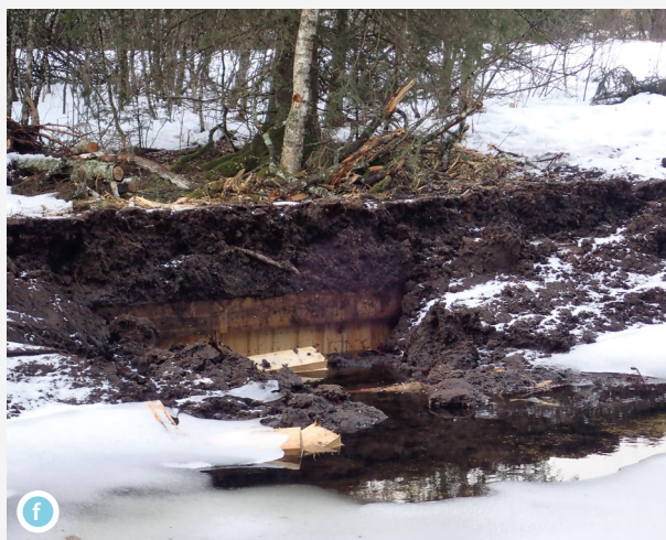
L'eau est passée sous la palissade non ancrée dans le substrat étanche pour ressortir de façon artésienne dans le point de fragilité créé par la gouille de prélèvement
