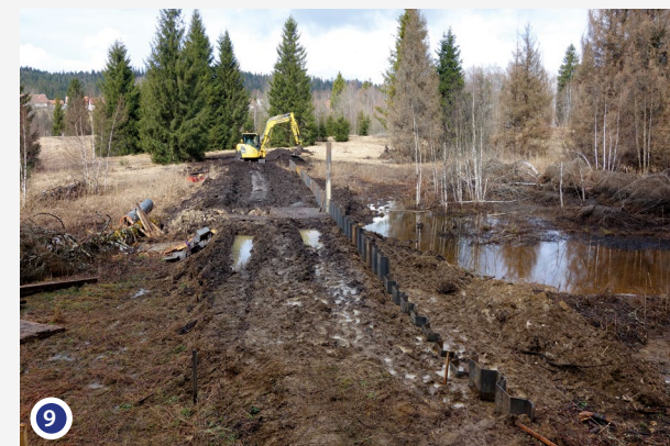
Renforcement de la digue par la mise en place d'un rideau de palplanches métalliques. Il sera ensuite recouvert de tourbe et se végétalisera
