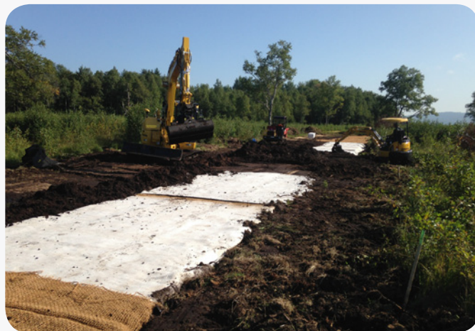
Une fois les palissades posées et recouvertes de tourbe, du matériel naturel (bentonite et natte de coco) protégera le sol de l'érosion par l'eau.
